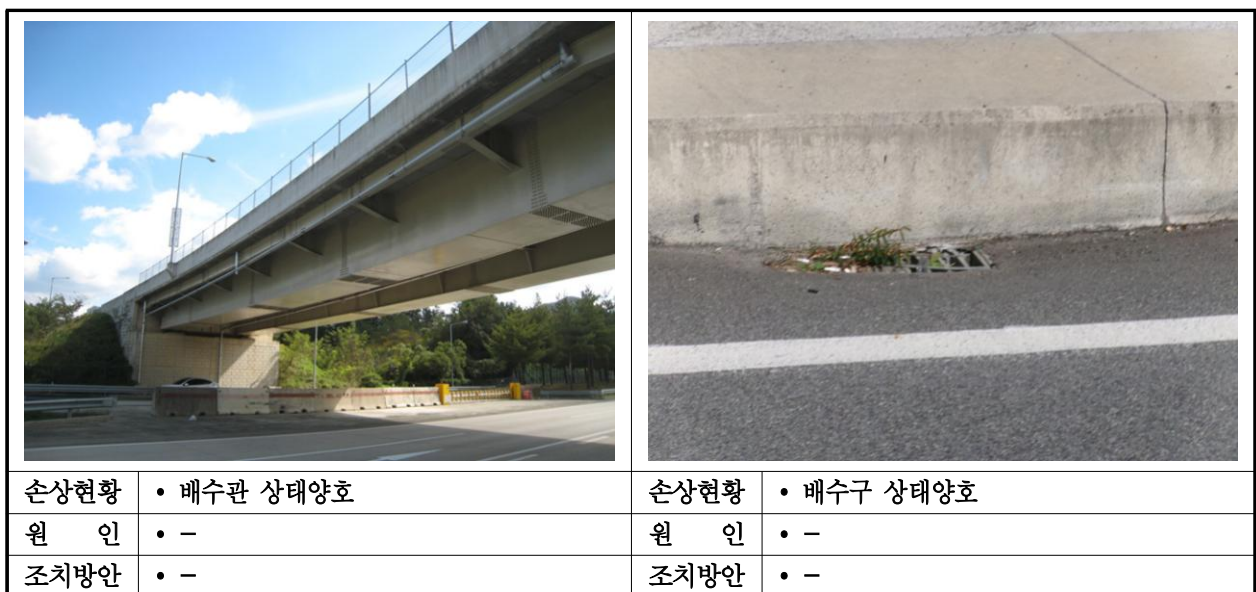
【사진 15.3.20】 배수시설 손상현황
